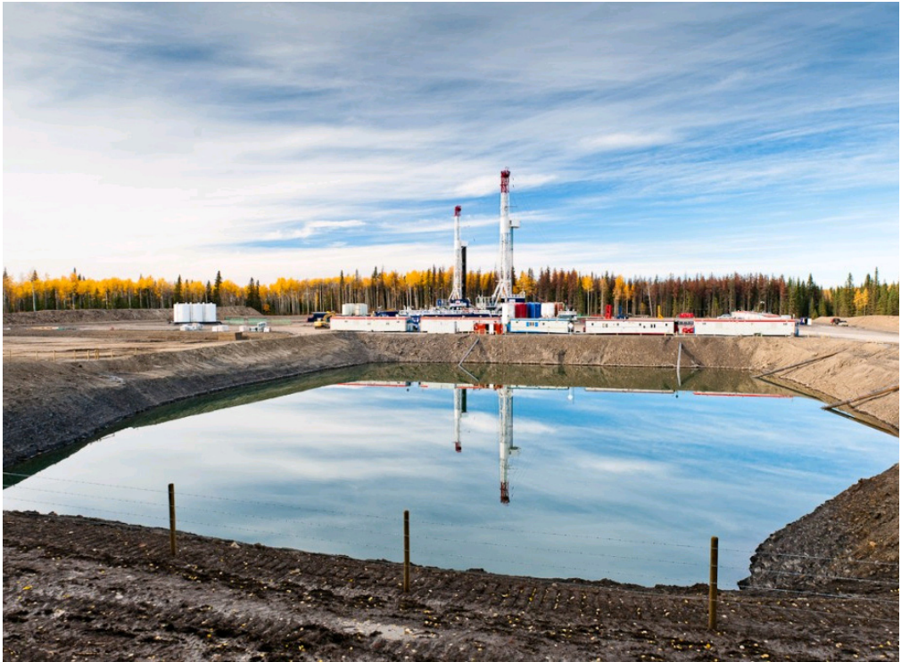
Figura 27. Bassa d'emmagatzematge del fluid de retorn
